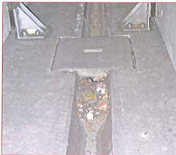
Fig. 6 - Zona di accumulo dello sporco
