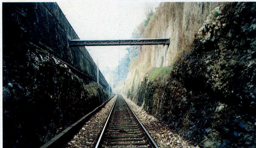
Fig. 8 - Linea Saronno-Laveno (Ferrovie Nord Milano Esercizio): risultati ottenuti a 19 mesi dall'intervento, confrontabili con la situazione preesistente in fig. 4 (è evidente l'avvenuto rifacimento del manufatto trasversale)
