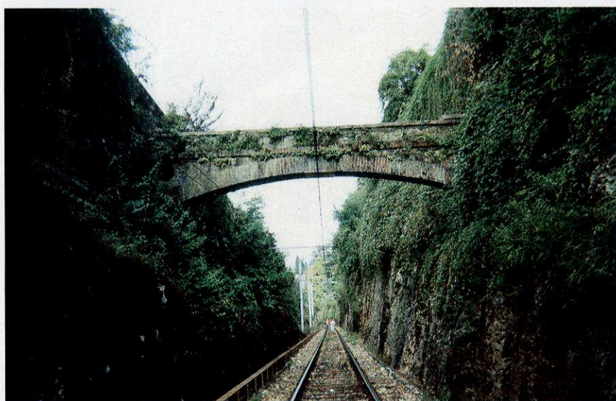
Fig. 4 - La parte superiore (a livello del manufatto trasversale) di questo muro di sostegno, da entrambi i lati, è costituita da calcestruzzo armato, e ciononostante è fittamente ricoperta da vegetazione (Linea Saronno-Laveno)
